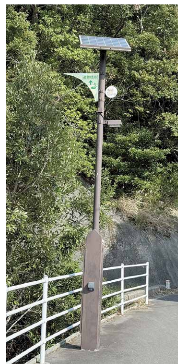
太陽光発電のLED防犯灯 (志布志市内)
