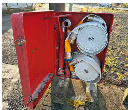
消防用ホース格納箱（三文字地区）
