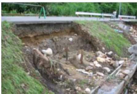
道路法面の崩壊状況
