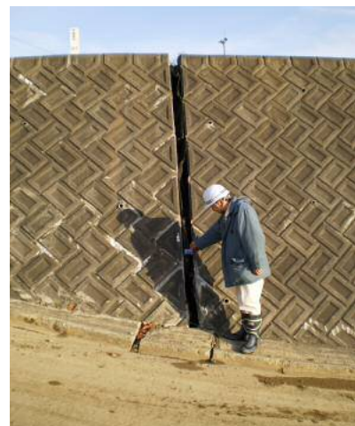
ブロック積みの隙間
