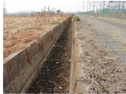
安全施設がない水路
