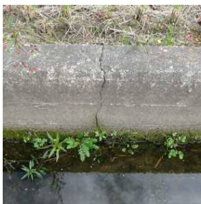
縦方向のひび割れ
