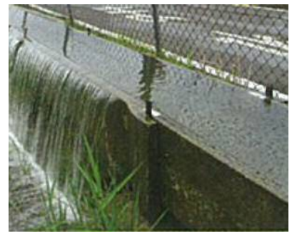
水路からの溢水
