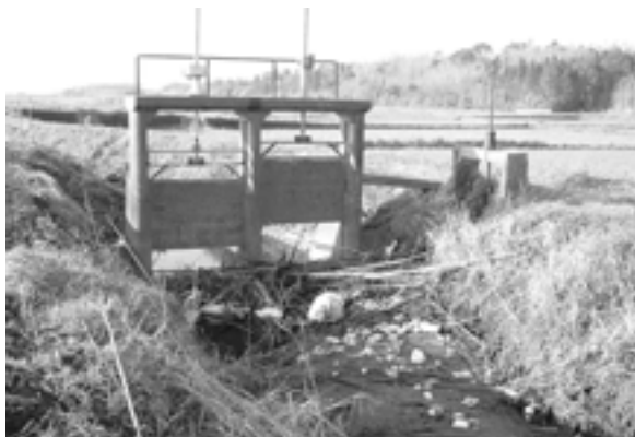
▲竹切れや投げ捨てられた空き缶、ペットボトルなどが、塩入川の用水取水施設(鷲塚集落下付近)をふさいでいる様子
