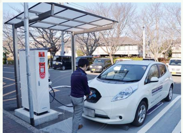
▲あすばる大崎駐車場に設置されたE V用急速充電器
