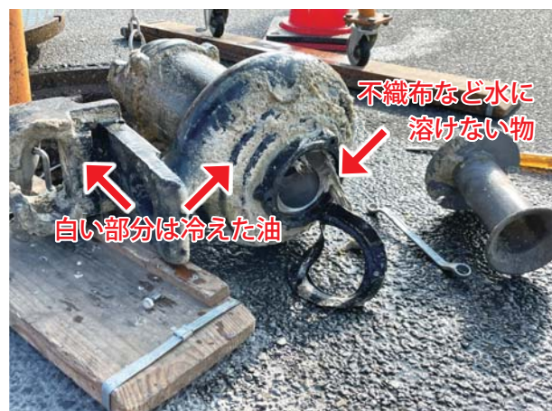
写真：西三文字MP場 2号ポンプの故障(不織布かみこみ)
