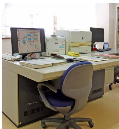
CRT 監視制御装置
