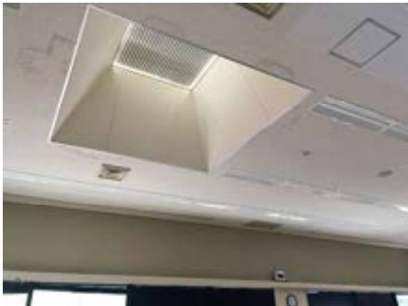
トップライト（天窓）からの漏水
