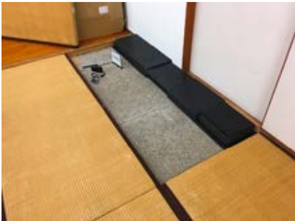
シロアリ被害調査
