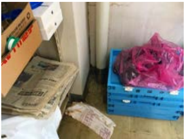
書庫雨漏り（床の状況）
